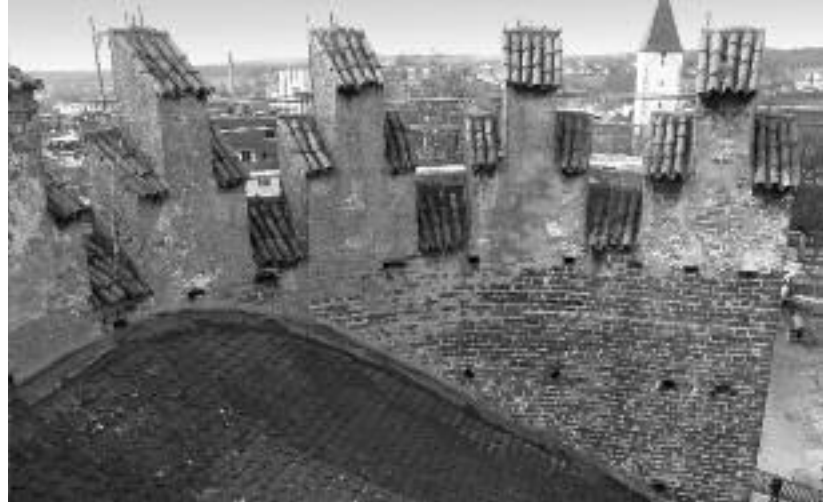
Putzflächen im Zinnenbereich (2009)
